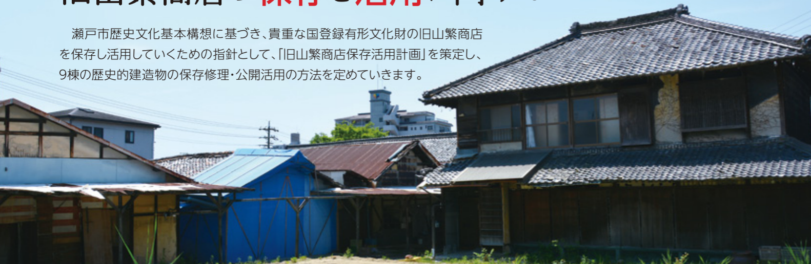
現在、一部の建物はシートで覆われた状態で保護されています。
