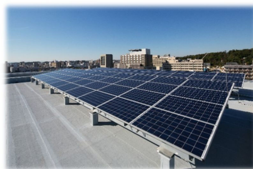
市役所新庁舎の太陽光発電システム
