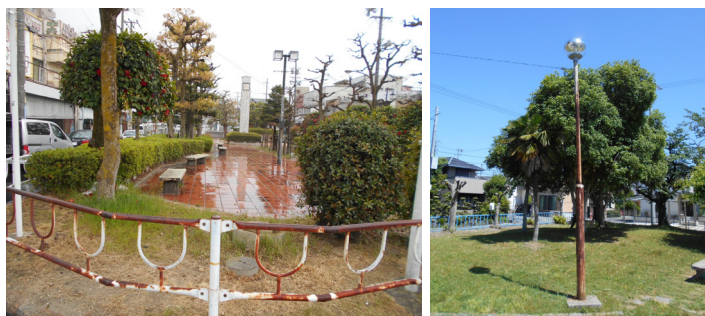
老朽化した施設
