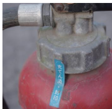
× キャップの劣化
