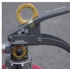
× 表示装置の脱落
