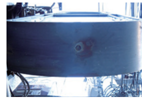
広告板底部の腐食、 水抜き孔の詰まり
