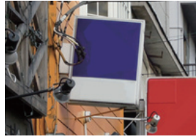
上部構造全体の傾斜、 ぐらつき
