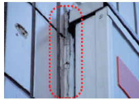
溶接部の劣化、コーキングの 劣化等
