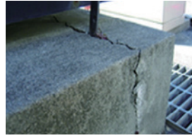
基礎のクラック、支柱と根巻 きとの隙間、支柱のぐらつき
