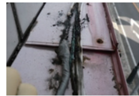
周辺機器（※）の劣化、破損 ※分電盤、配線、変圧器（トランス）、スイッチ等
