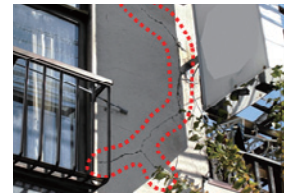
取付対象部（柱・壁・スラブ）・ 取付部周辺の異常
