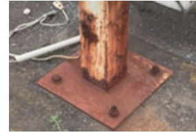
鉄骨のさび・ 塗装の老朽化
