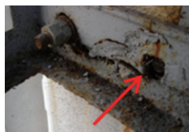
アンカーボルト・取付部プ レートの腐食、変形
