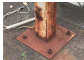
鉄骨のさび・ 塗装の老朽化
