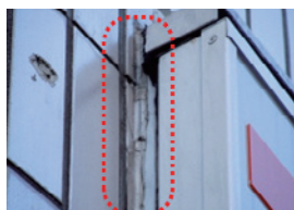
溶接部の劣化、コーキングの 劣化等
