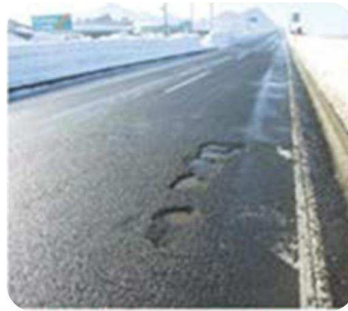
路面の穴ぼこ・ 段差
