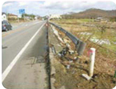
ガードレール・ 標識等の損傷
