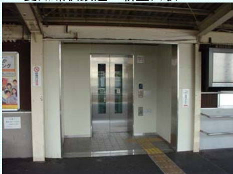
エレベーターの設置事例 ～愛知環状鉄道 新豊田駅～
