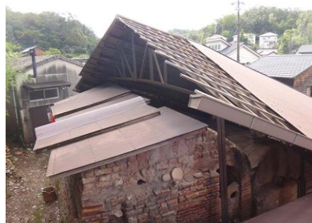
洞本業窯保存修理(台風被害直後修理前状況) (窯最上部を覆うトタン屋根がなくなり、 煙出(コクド)部分のトタンも飛散しかかる)
